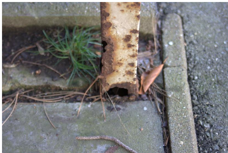
Verankerungen fast durchgerostet!
